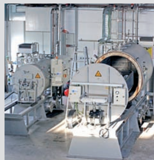
Thermal cleaning / Thermische Reinigung
